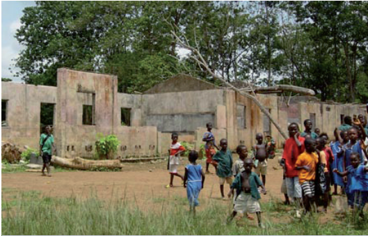
مدرسة كويندو الابتدائية دُمرت بالكامل خلال الحرب الأهلية السيراليونية التي دامت ١١ عاماً. واستخدم الجنود المتمردون هذه المدرسة قاعدة عسكرية ومركزاً للتدريب واستخدموا الكتب والأثاث المصنوع من الخشب لإشعال النيران. ولم يبقَ بعد الحرب سوى هياكل المباني لا سقف لها.
